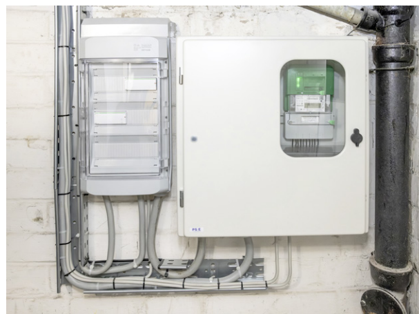
Der physische Summenzähler ist in aller Regel eine Wandlerrmessung mit eigenem Wandlerschrank.
